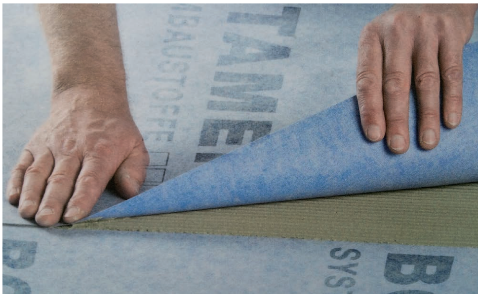
FOT. 2. Przyklejanie maty uszczelniająco-kompensującej za pomocą elastycznej zaprawy klejowej BOTAMENT® M 21 lub BOTAMENT® M 10 Speed z zachowniem 5 cm zakładu. Nie ma konieczności doszczelniania zakładu
