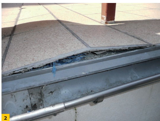
FOT. 1–2. Skutki lekceważenia zasad wykonywania tarasu;
