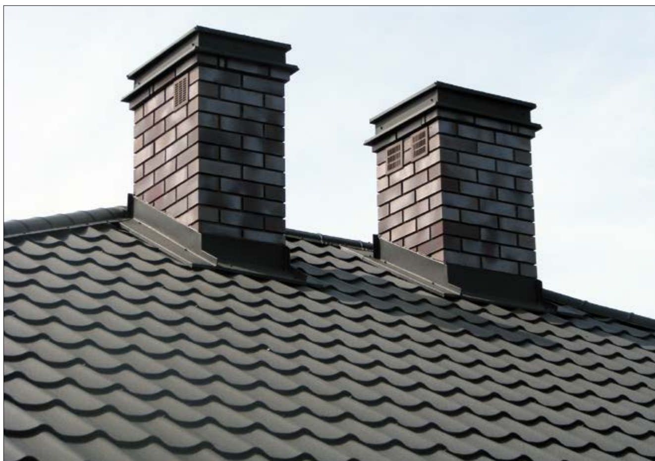
Fot. 1. Straty przez źle zaizolowany dach mogą wynosić nawet 25% wszystkich strat ciepła w budynku Fot. J. Guzal
