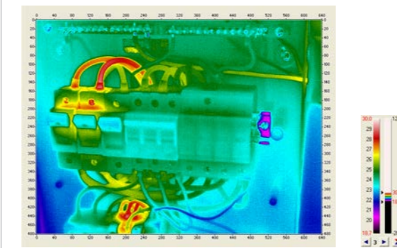
Fot. 1. Przykład przeglądu rozdzielnicy nn z użyciem kamery termowizyjnej
