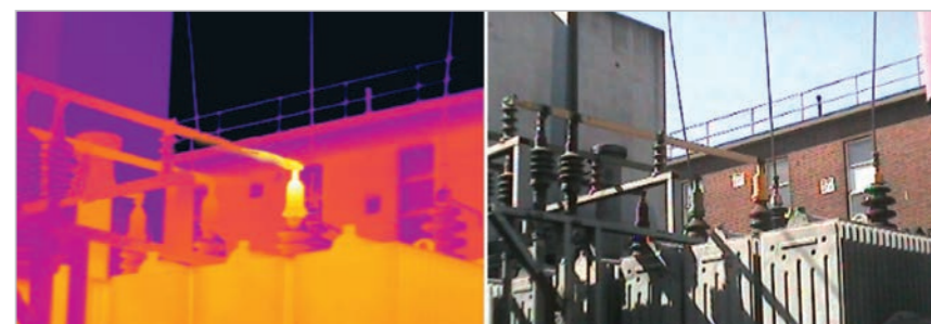
Fot. 4. Transformator w trakcie pracy
