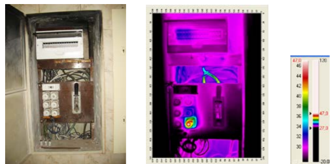
Zdjęcie w świetle widzialnym i podczerwieni rozdzielnic nn w budynku
