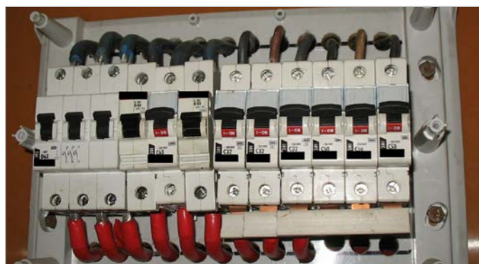
Fot. 2. Widok wyłączników nadmiarowoprądowych w świetle widzialnym
