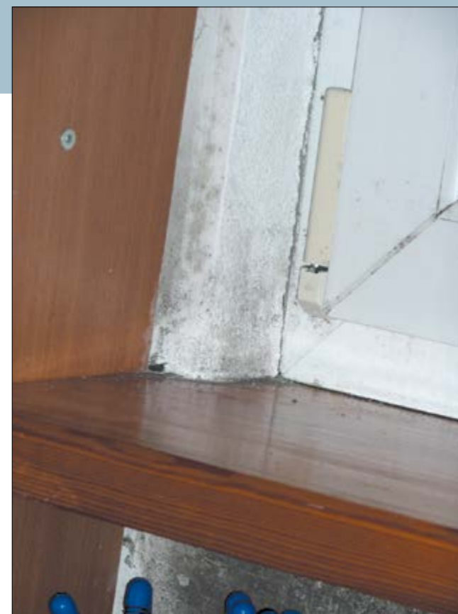
Obecność grzybów pleśniowych jest skutkiem występowania kondensacji wilgoci na powierzchni przegrody
