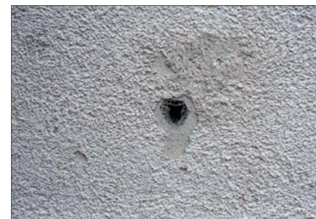
Uszkodzenie mechaniczne spowodowane przez uderzenie twardym przedmiotem
