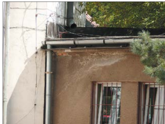
Zniszczenia na skutek oddziaływania wód opadowych Rys. M. Rokiel
