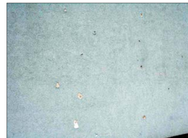
Uszkodzenia spowodowane przez gradobicie
