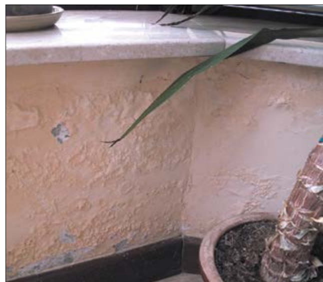
Skutki braku izolacji pionowej od strony wewnętrznej w budynku niepodpiwniczonym oraz przecieki na skutek błędów w obsadzeniu okien i parapetów Fot. M. Rokiel
