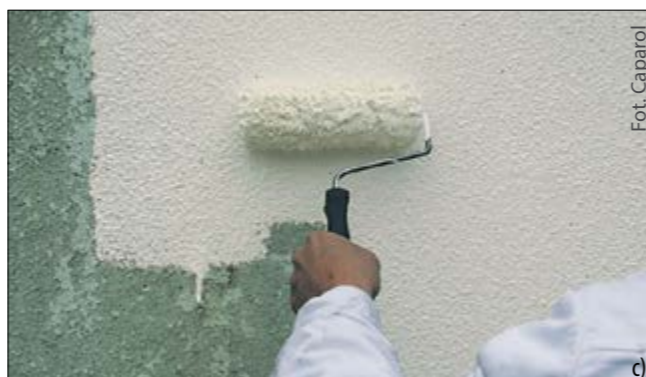
Zabiegi biobójcze: usuwanie nalotu wodą pod ciśnieniem (a), odkażanie powierzchni preparatem biobójczym (b), malowanie powierzchni (c)
