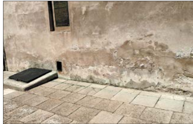
Skutki braku zabezpieczenia przed oddziaływaniem wody rozbryzgowej Rys. M. Rokiel
