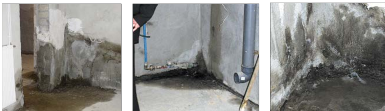
Skutki braku izolacji w piwnicy budynku mieszkalnego
