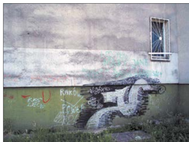
Graffiti na elewacji
