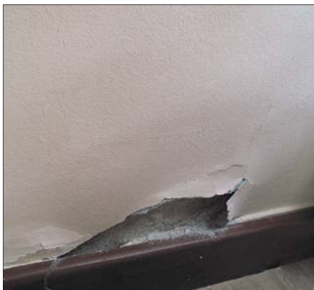
Skutki braku szczelności połączenia izolacji poziomej na ławach i izolacji podposadzkowej Fot. M. Rokiel
